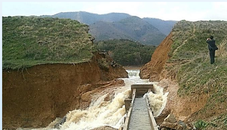
복통 누수로 토사 유출 → 제체붕괴 사고발생
