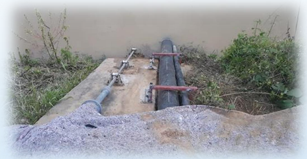
사이펀 취수시설 시공사례 (신후평지)
