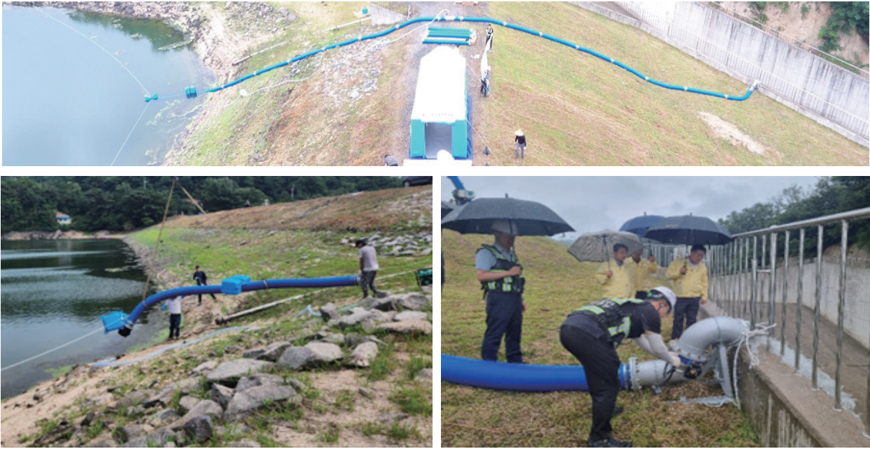
그림 8. 화산저수지 이동식 사이펀 긴급방류시설 설치 사례
