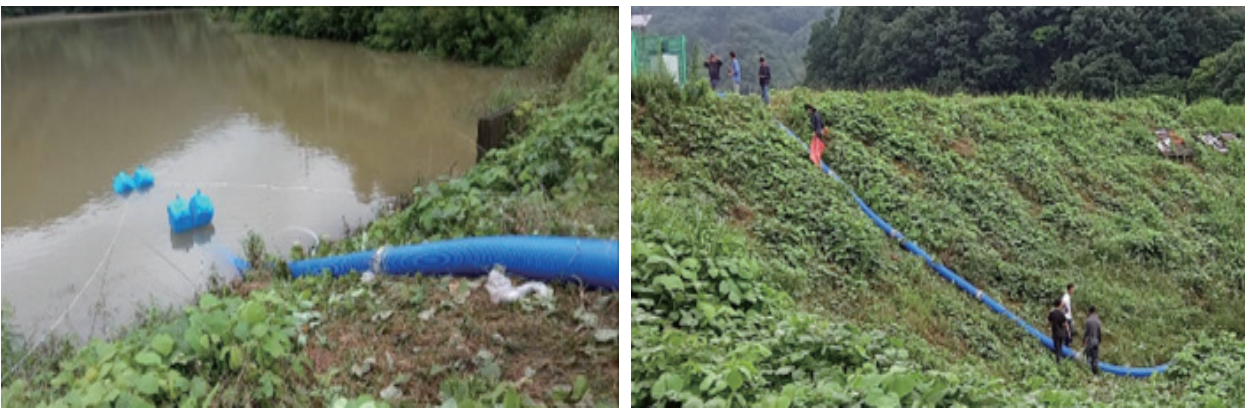
그림 9. 장산저수지 이동식 사이펀 긴급방류시설 설치 사례
